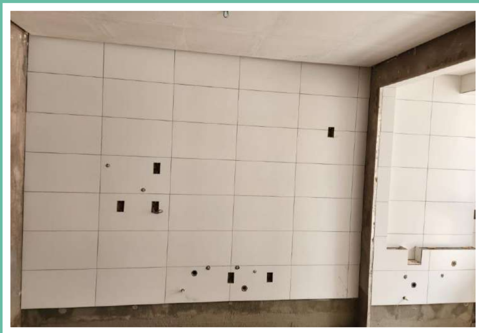
Revestimento padrão, paredes de cozinhas e áreas de serviço do 3º pavimento - Fevereiro 2024
