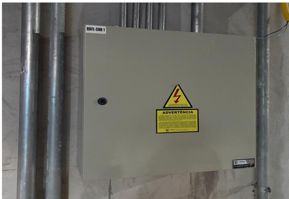
Alimentação dos quadros gerais e parciais – Novembro 2025
