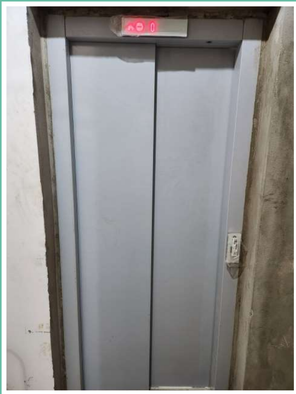
Elevador de serviço – Torre – Julho 2024
