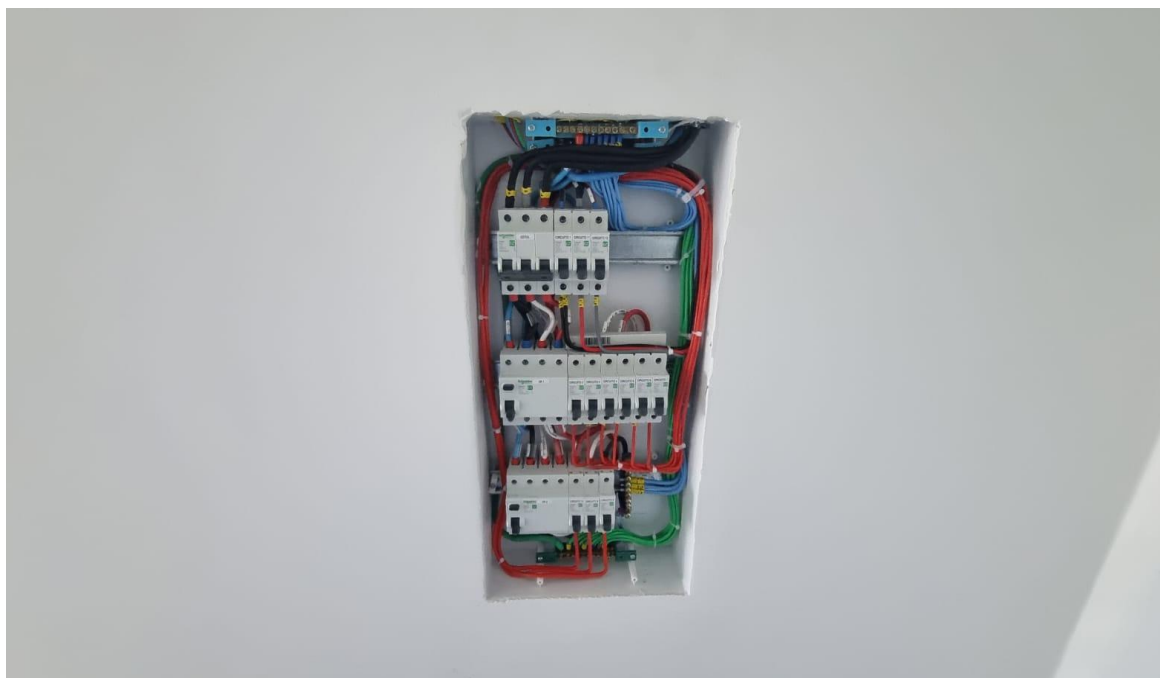
Quadro de distribuição do 10º pavimento – Maio 2025
