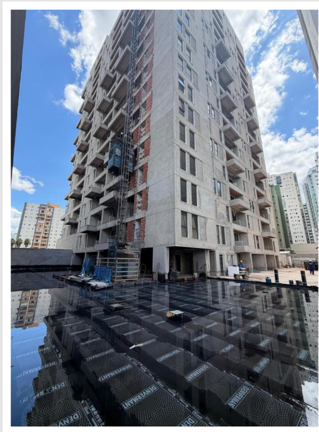
Execução e teste da impermeabilização do piso do térreo (região da garagem) – Fevereiro 2026
