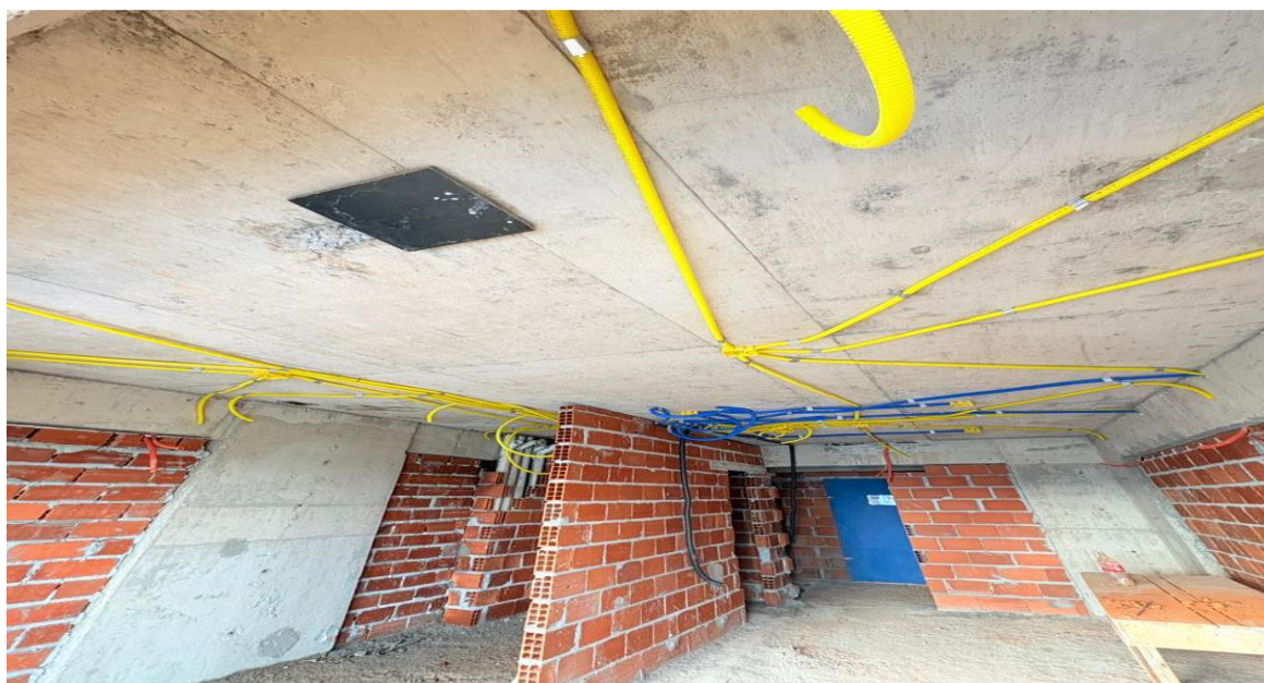
Instalações elétricas de teto e parede do 4º pavimento da Torre Parque – Novembro 2025
