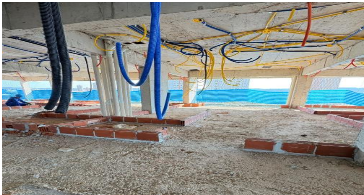
Estrutura elétrica de teto 5°, 6° e 7° pavimento da Torre Parque – Dezembro 2025
