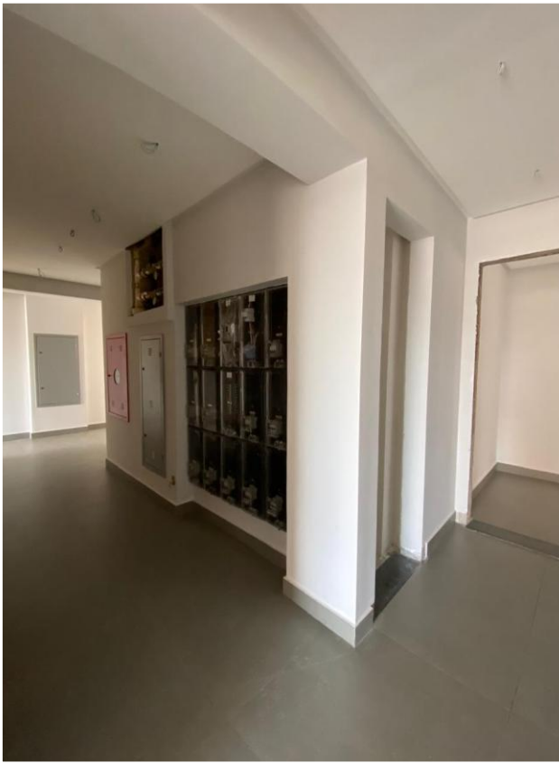
Hall de medidores do 15º pavimento da Torre Lua – Junho 2025
