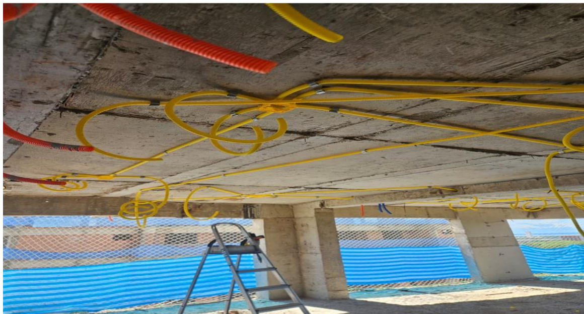
Instalações elétricas de teto no 13° pavimento da Torre Parque – Fevereiro 2026
