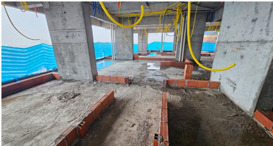
Instalações elétricas de teto no 14° pavimento da Torre Lago – Fevereiro 2026
