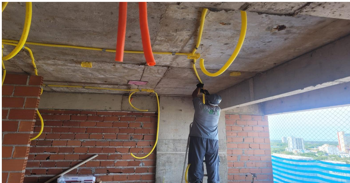
Instalações elétricas de teto até o 15º pavimento da Torre Lago – Março 2026
