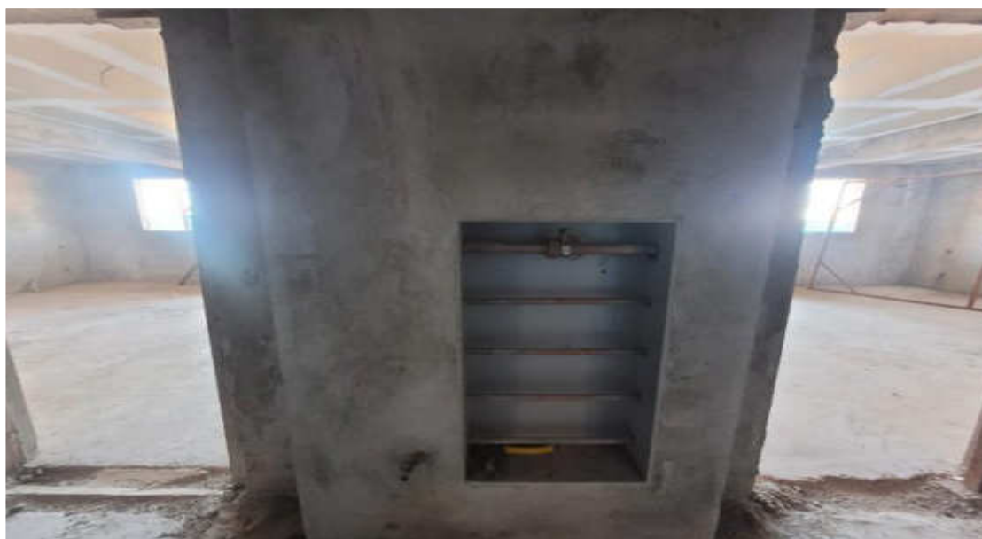
Shaft da Prumada de hidrômetro do 5° pavimento da Torre Lago – Junho 2026
