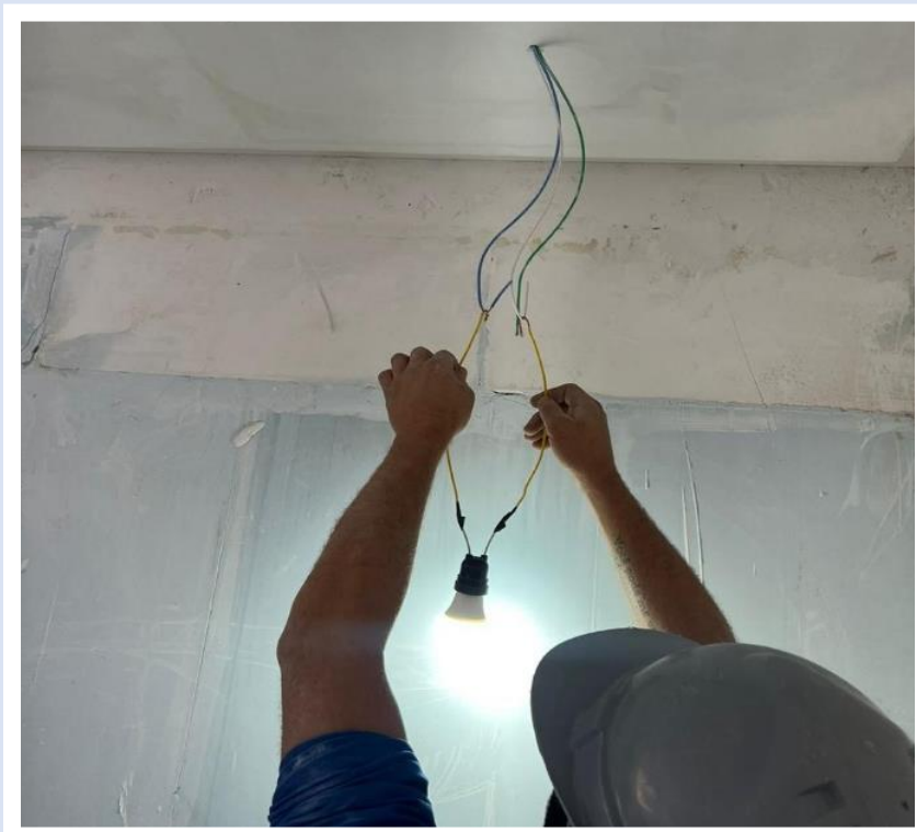
Teste elétrico da penthouse da Torre Lua – Janeiro 2025
