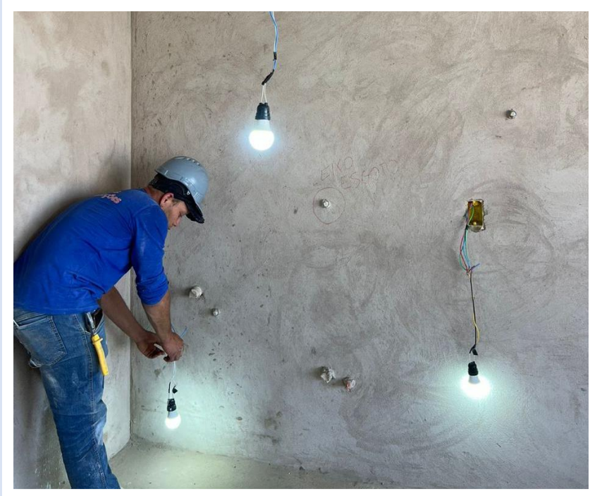
Teste elétrico da penthouse da Torre Lua – Janeiro 2025
