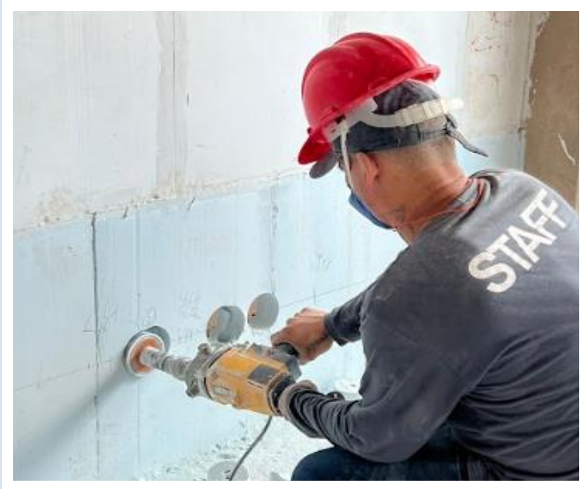
Instalações elétricas do 36º pavimento da Torre Lua – Dezembro 2024
