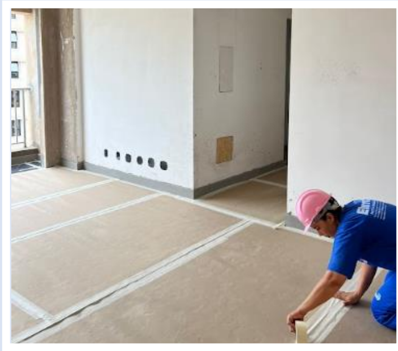
Rejuntamento e proteção de piso do 14º pavimento da Torre Lua – Novembro 2024
