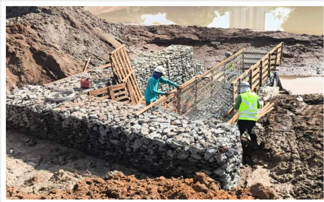
Execução de PVs da galeria pluvial / Instalação das tampas dos PV's da galeria pluvial – Fevereiro 2026
