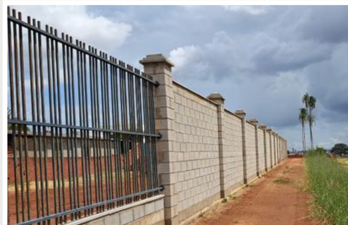
Execução do muro (incluso impermeabilização da fundação do muro, garantindo a qualidade construtiva e prevenindo patologias futuras) – Fevereiro 2026
