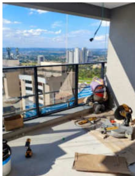
Guarda-corpo de alumínio/vidro dos apartamentos finais 3 e 4 – Maio 2026
