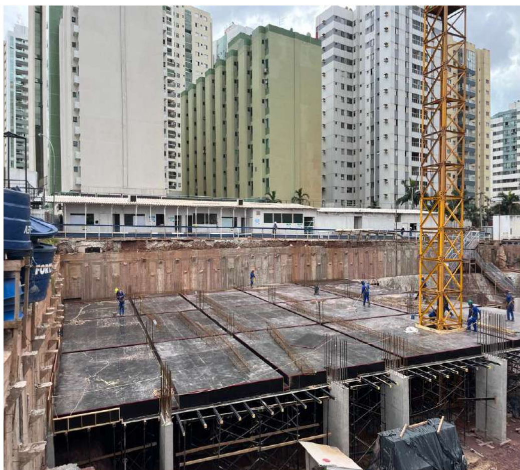
Montagem da forma da 1ª etapa da laje do 1º subsolo e armação das vigas – Março 2024
